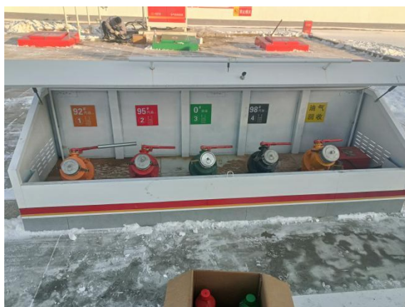
卸油油气回收装置
