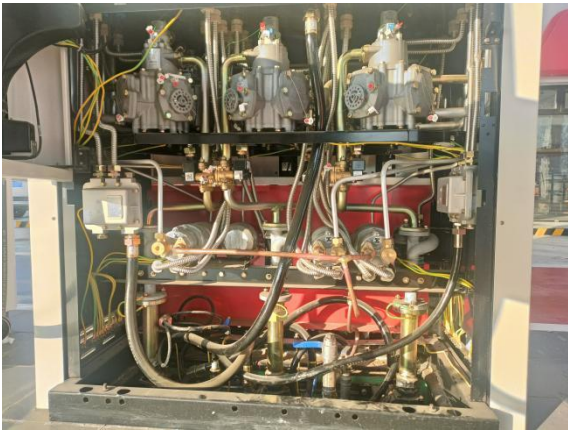
加油油气回收装置
