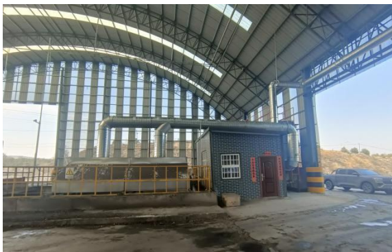
1#卸煤棚破碎集气罩
