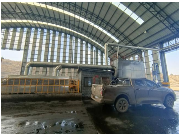
2#卸煤棚破碎集气罩
