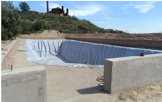
雨水收集池（前）
