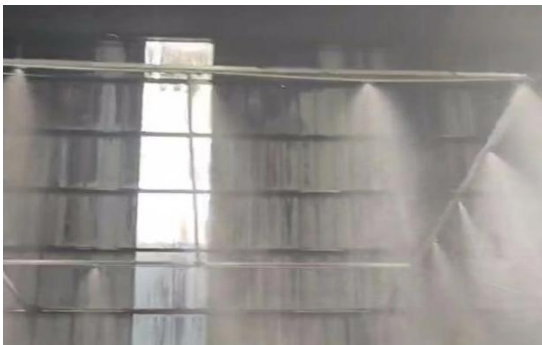
受煤坑上方水雾喷头
